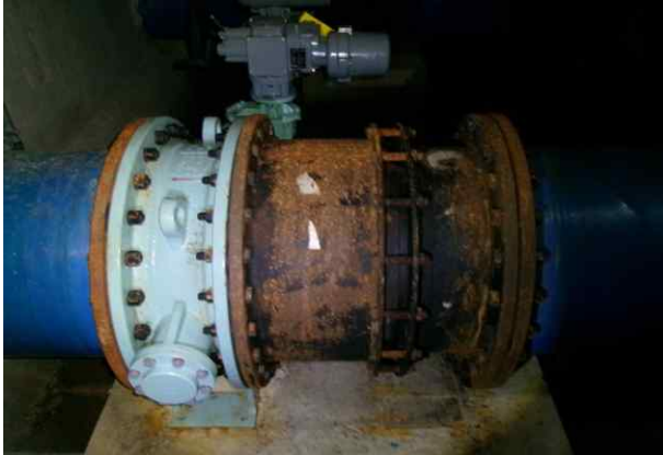
손상내용 유입배관실 배관설비 관부식 손상원인 도장열화, 공용기간 경과
