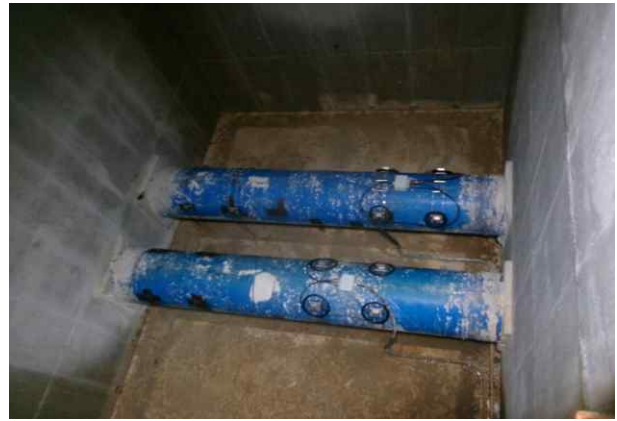
유량계실 내부 전경
