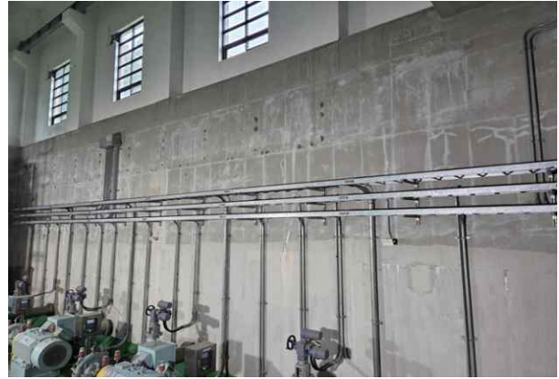
펌프실 지하 내부 전경
