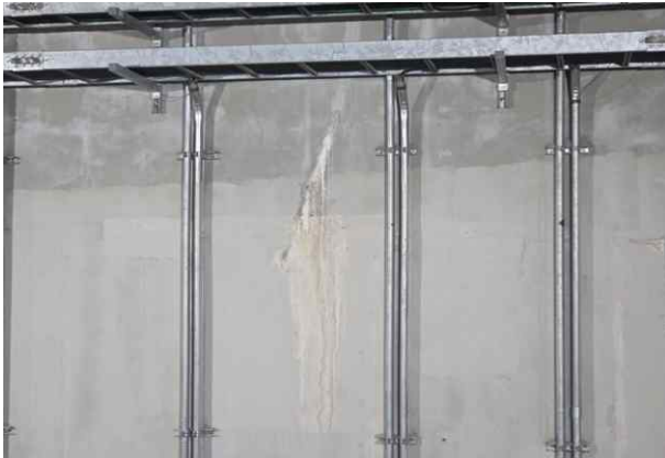
손상내용 펌프실 지하 내부벽체 백태 손상원인 열화부 수분침투
