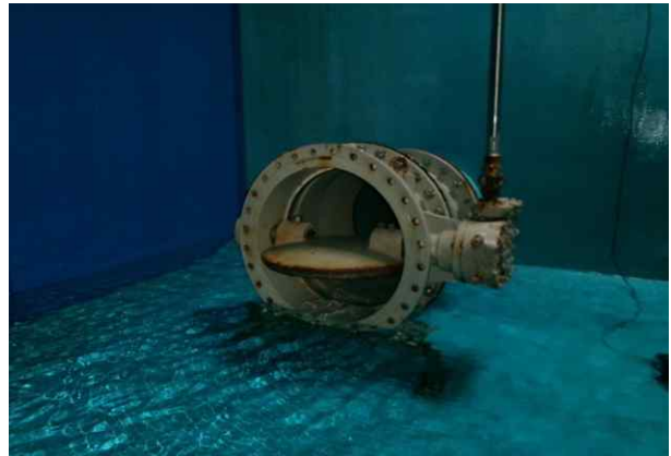
손상내용 저류지 유출 수동밸브 상태양호 손상원인 -
