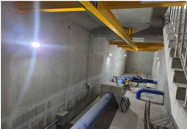
3~4호지 유입밸브실 내부 전경
