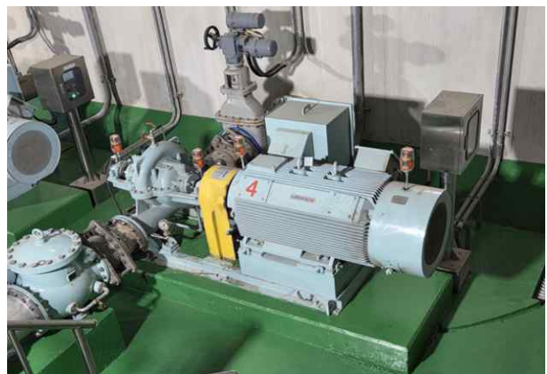
손상내용 펌프 상태양호 손상원인 -
