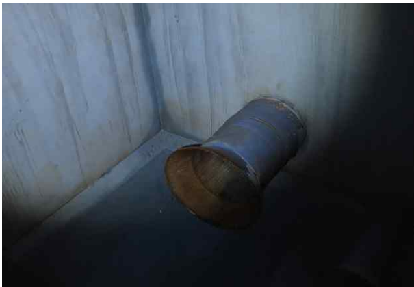
손상내용 배수지 3지 유출배관 부식 손상원인 도장열화, 수분접촉
