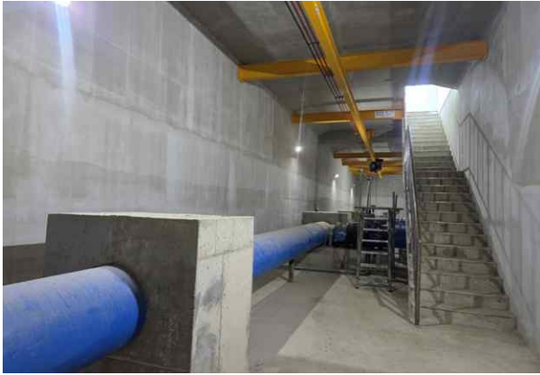
1~2호지 유입밸브실 내부 전경
