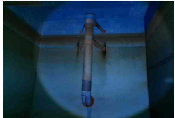
손상내용 배수지 3지 유입배관 부식 손상원인 도장열화, 수분접촉
