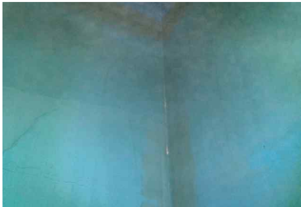
손상내용 2지 벽체 균열부백태 손상원인 건조수축 + 수분침투
