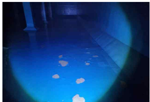
손상내용 2지 바닥슬래브 도장박리 손상원인 공용중 열화
