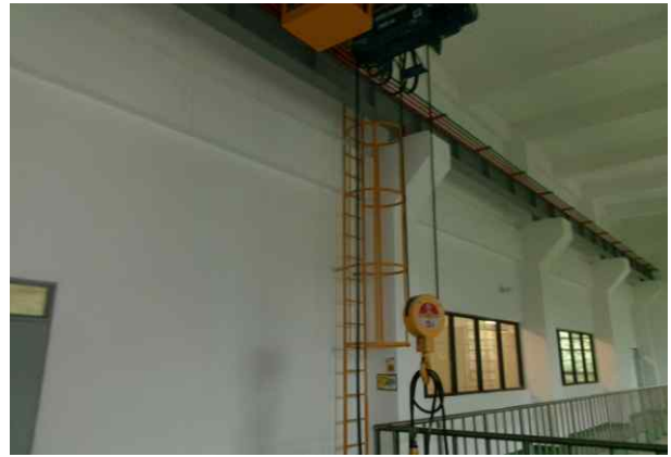
호이스트 진입사다리 상태양호
