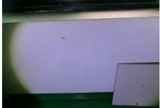
손상내용 펌프실 지상1층 벽체 몰탈균열 손상원인 건조수축, 온도변화
