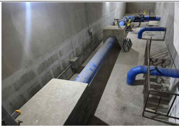
기계설비(3~4호지 밸브 및 배관)
