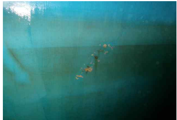
손상내용 2지 벽체 도장박락 손상원인 공용중 열화, 청소시 고압수 등
