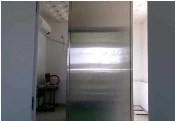
전기실 내부 전경
