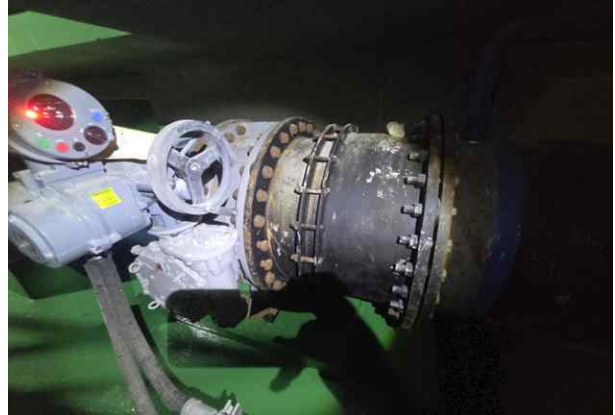
손상내용 유출배관실 배관설비 관부식 손상원인 도장열화, 공용기간 경과
