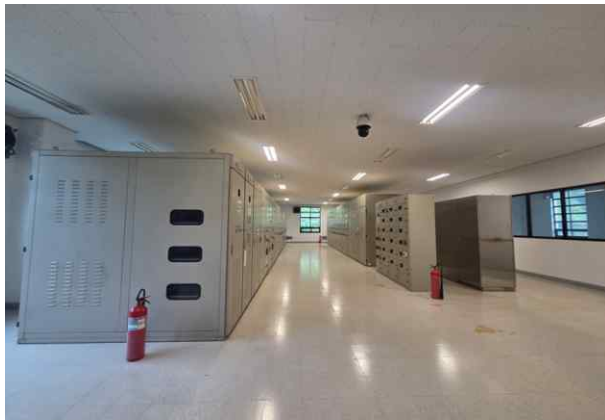
전기실 내부 전경
