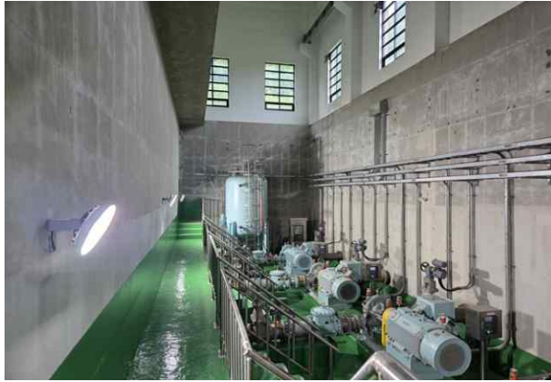
펌프실 지하 내부 전경
