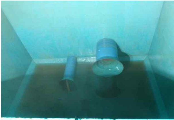
손상내용 배수지 2지 유출배관 부식 손상원인 도장열화, 수분접촉
