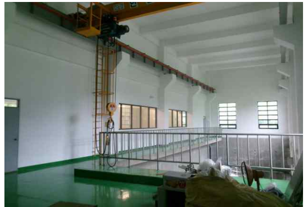
펌프실(지상) 내부 전경
