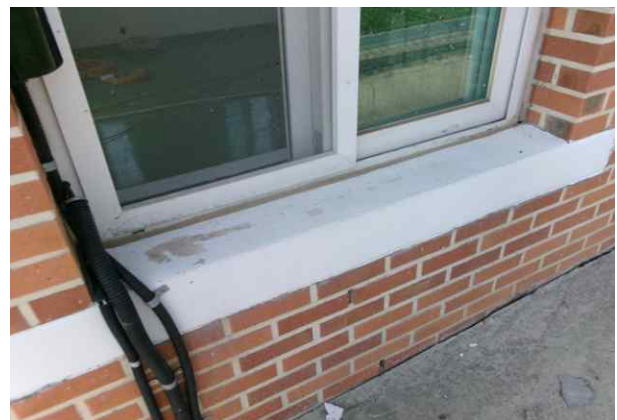
손상내용 1~2호지 검수실 외부 균열(0.3mm미만) 손상원인 건조수축, 온도변화
